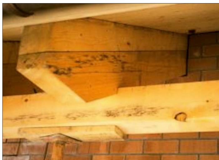
Tache bleue non esthétique sur poutre apparente
